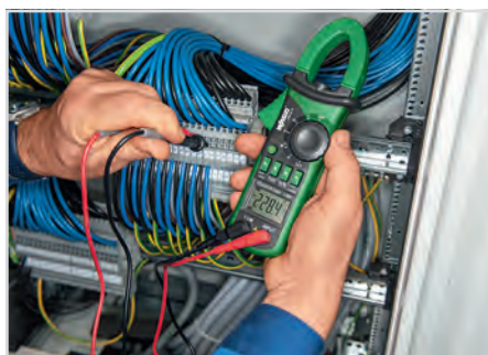
在开关柜中进行电流测量
