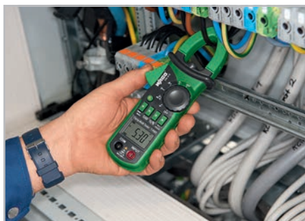
在开关柜中进行电流测量
