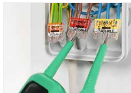
通过进线孔正对的测试插孔进行测试。
