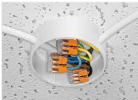
天花板吊顶照明配电
