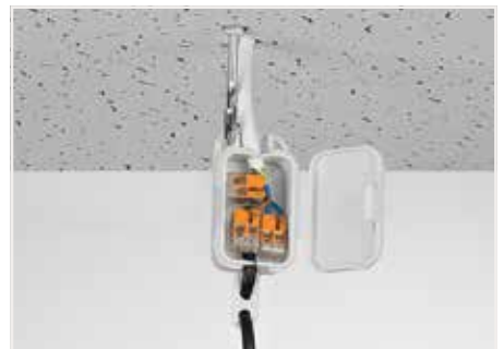
天花板吊灯接线
