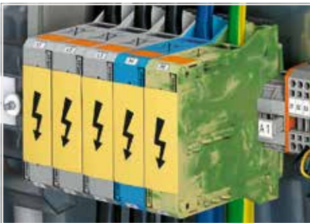
保护兼警告标志表示: 注意! 尽管电流已被切断, 但电压依然存在。
