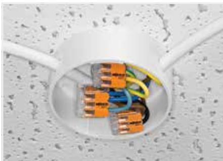
天花板吊顶照明配电
